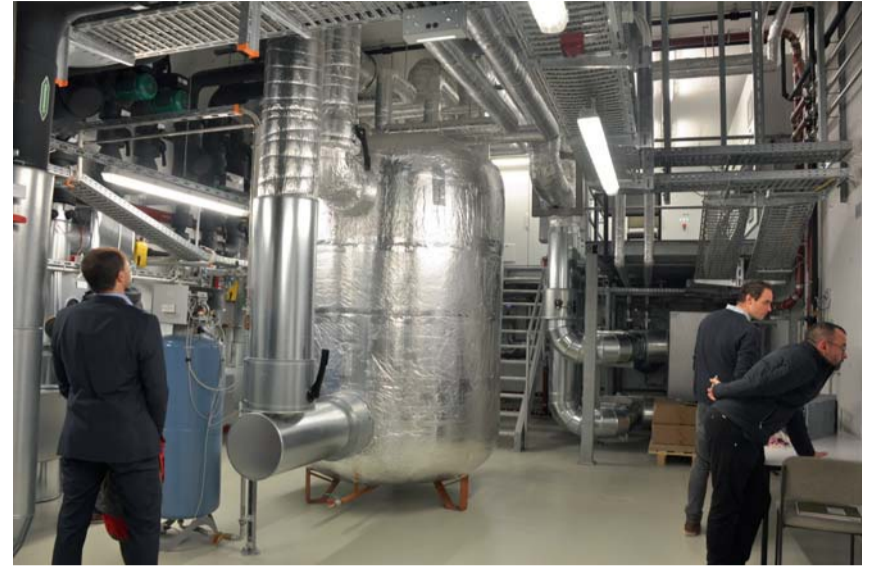
Die Versorgungstechnik eines High Performance Computing (HPC) Rechenzentrums mit integrierter Abwärmenutzung. Die Serverabwärme wird zum Heizen von Bürogebäuden verwendet. (Abb. cci Dialog GmbH)
